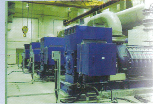
緊急發電機 Generator
