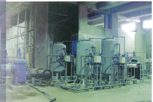
回收水系統 Reuse Water System
